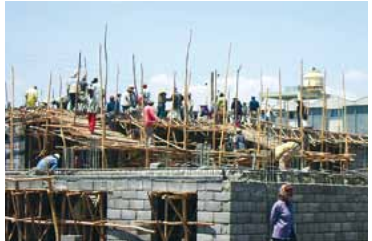
Eine der unzähligen Baustellen in Addis Abeba. Die Stadt rüstet sich für den rasanten Bevölkerungszuwachs. (Bild: Bisrat Kifle)
